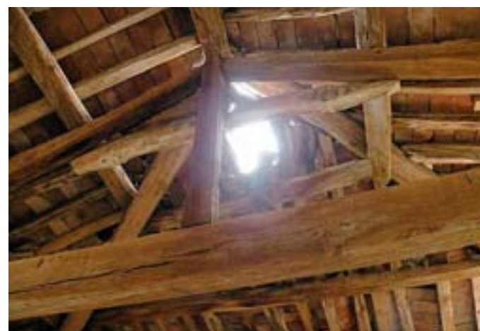
Le condizioni del tetto, prima del restauro
